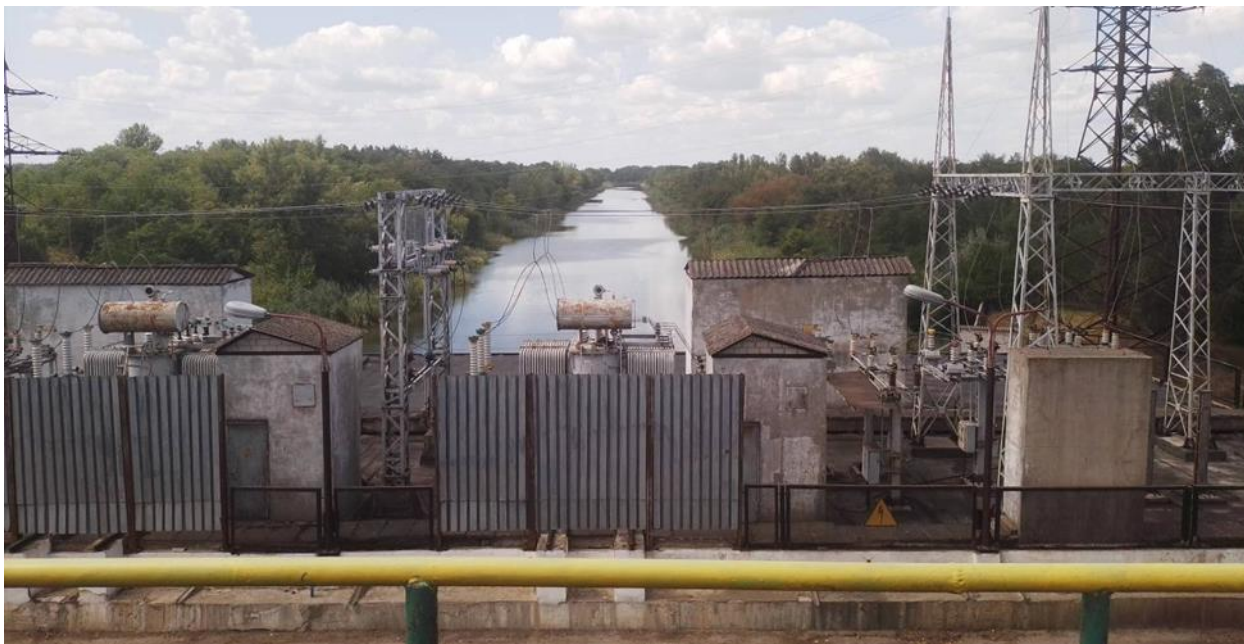
Рисунок 3-1 Застарілі трансформатори та основне силове обладнання на каналі Дніпро–Донбас
