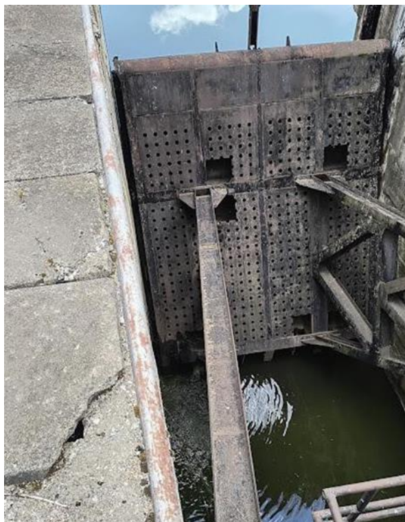
Рисунок 3-8 Протікання води крізь ущільнювальні елементи шлюзових воріт
